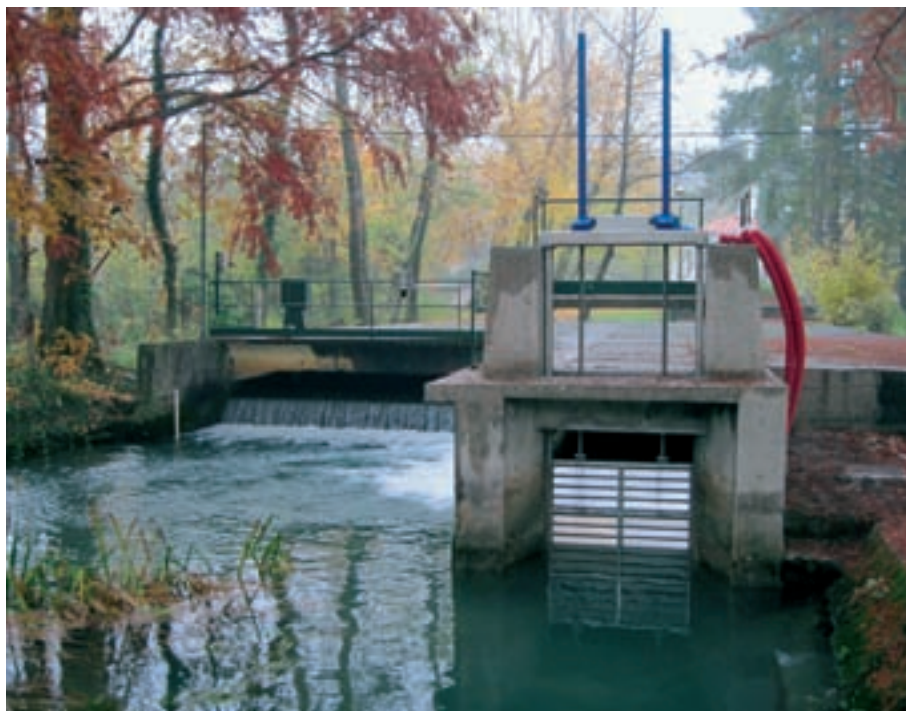
Fig. 6 - Stramazzo e paratoia alle sorgenti Sardos prossime a quelle del Timavo - Weir and gate at the Sardos Spring, close to the Timavo Springs.
